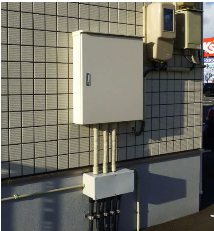
ロードヒーティング制御盤
